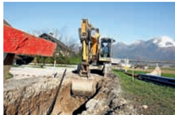
Gradnja fekalne kanalizacije v okviru projekta Gorki na severnem delu občine je stekla jeseni.
